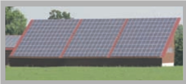
Installation non protégée
